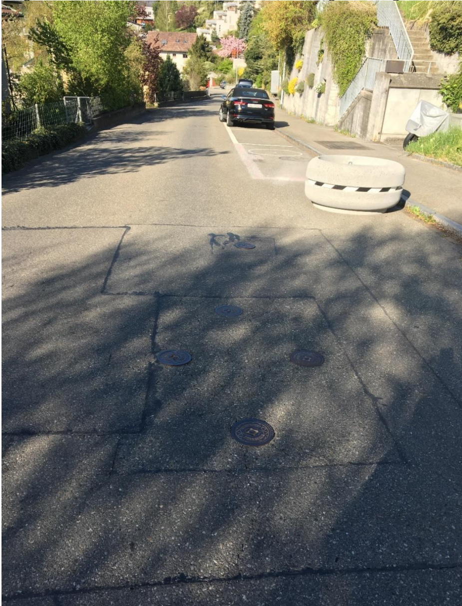
Abbildung 18: IST-Zustand Foto, Belagsflicke Wasserleitung (Schieber)
