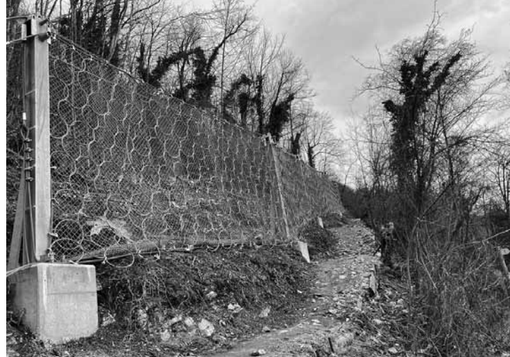
Steinschlagnetz am Geissberg: Schutz des Siedlungsgebiets.
