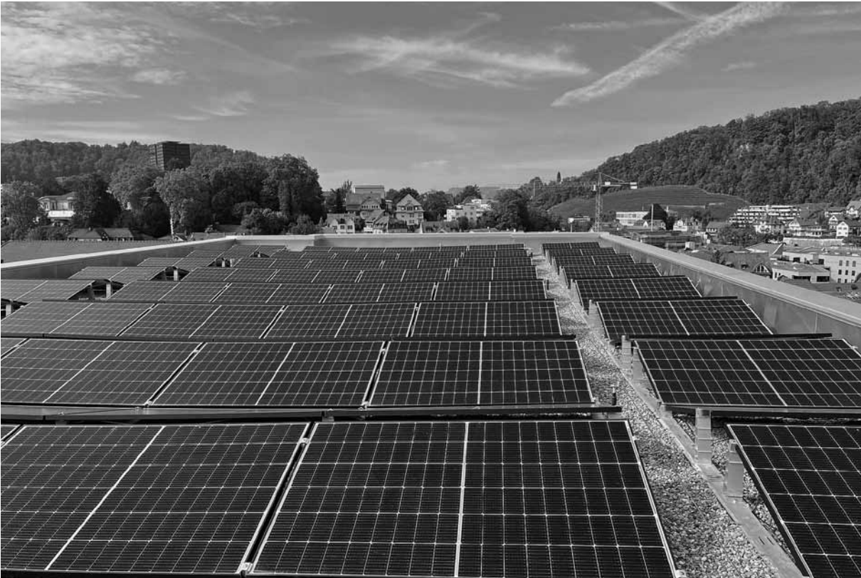
Fotovoltaikanlage auf dem neuen Schulhaus Bachtal: Internationale Abkommen lokal umsetzen.
